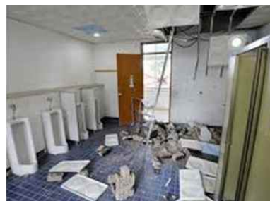
[그림 2] 화장실 천정 탈락 사례
