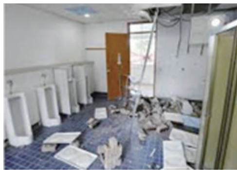
[그림 2] 화장실 천정 탈락 사례
